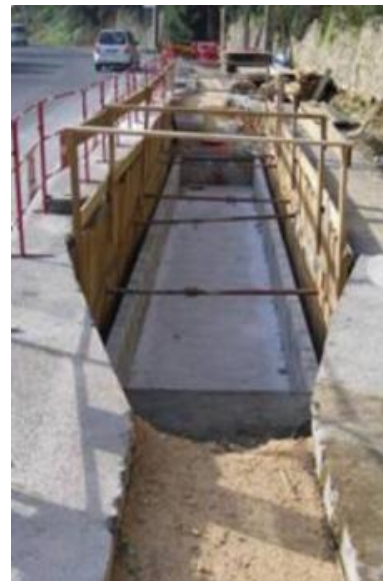
Chambre de jonction
